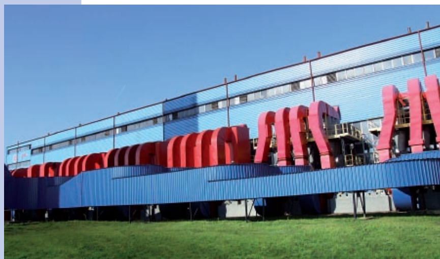
RADPEC pozyskał dotacje unijne, które umożliwiły mu m.in. zmodernizowanie układów odpylania gazów odlotowych w radomskich ciepłowniach
